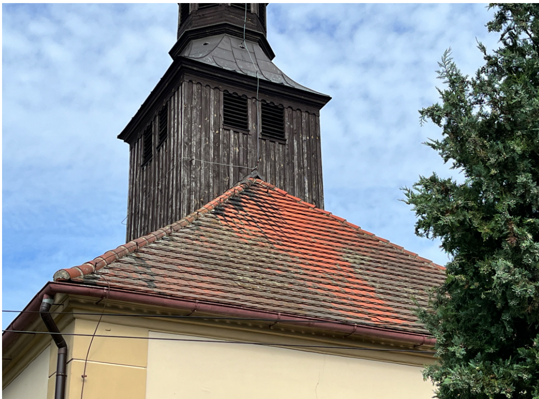
Fot. 2. Zbliżenie na wschodnią połać dachu kościoła oraz elewację wieży - widoczne ubytki powierzchni dachówek oraz przebarwienia pokrycia dachu wynikające z intensywnego rozwoju kolonii mikroorganizmów i bakterii. W przypadku elewacji wieży zauważalny jest ubytek ochronnej powłoki malarskiej oraz zbielenie odsłoniętego drewna, będące efektem porażenia grzybami zgnilizny jasnej.
