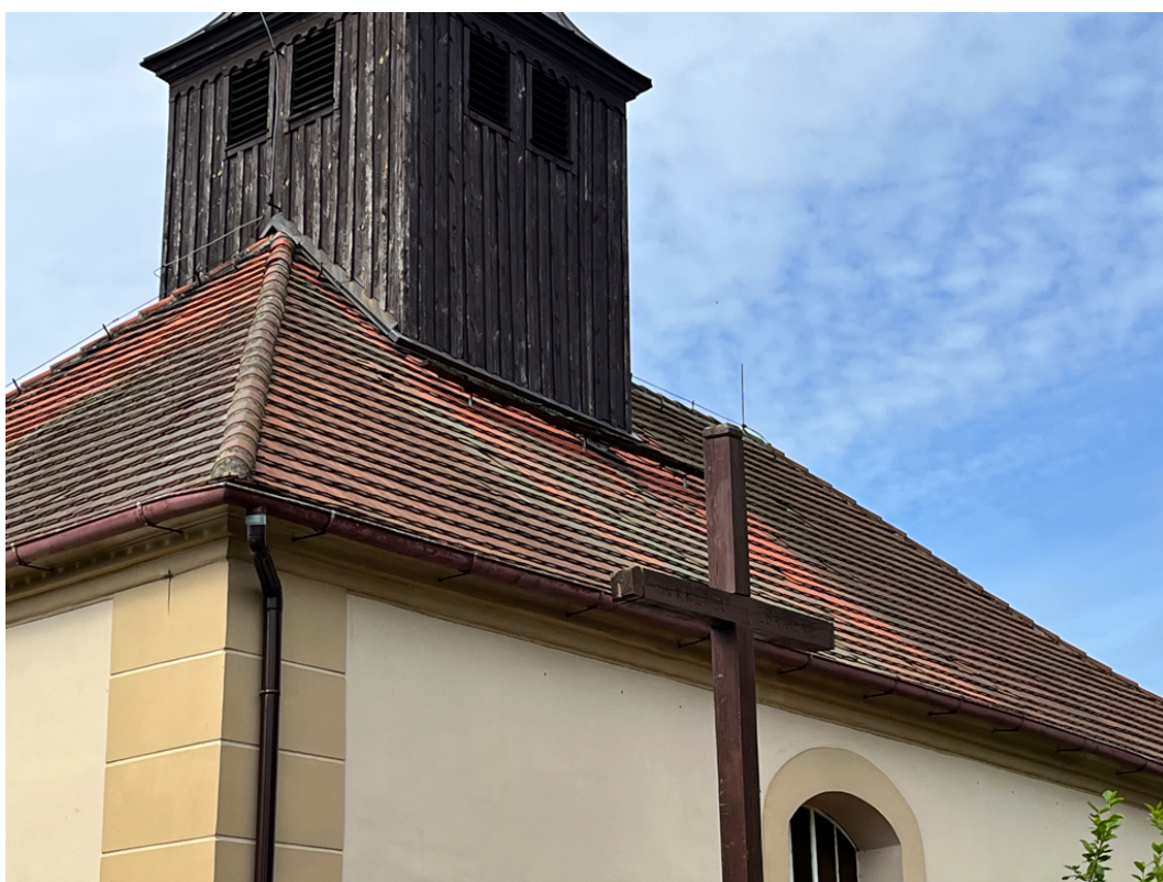
Fot. 4. Zbliżenie na północną połacie dachu kościoła, aktualny stan zachowania. Widoczne m.in. liczne ubytki powierzchni dachówek oraz kotwy montażowe wtórnych rynien, przytwierdzone do gzymsu koronującego kościoła
