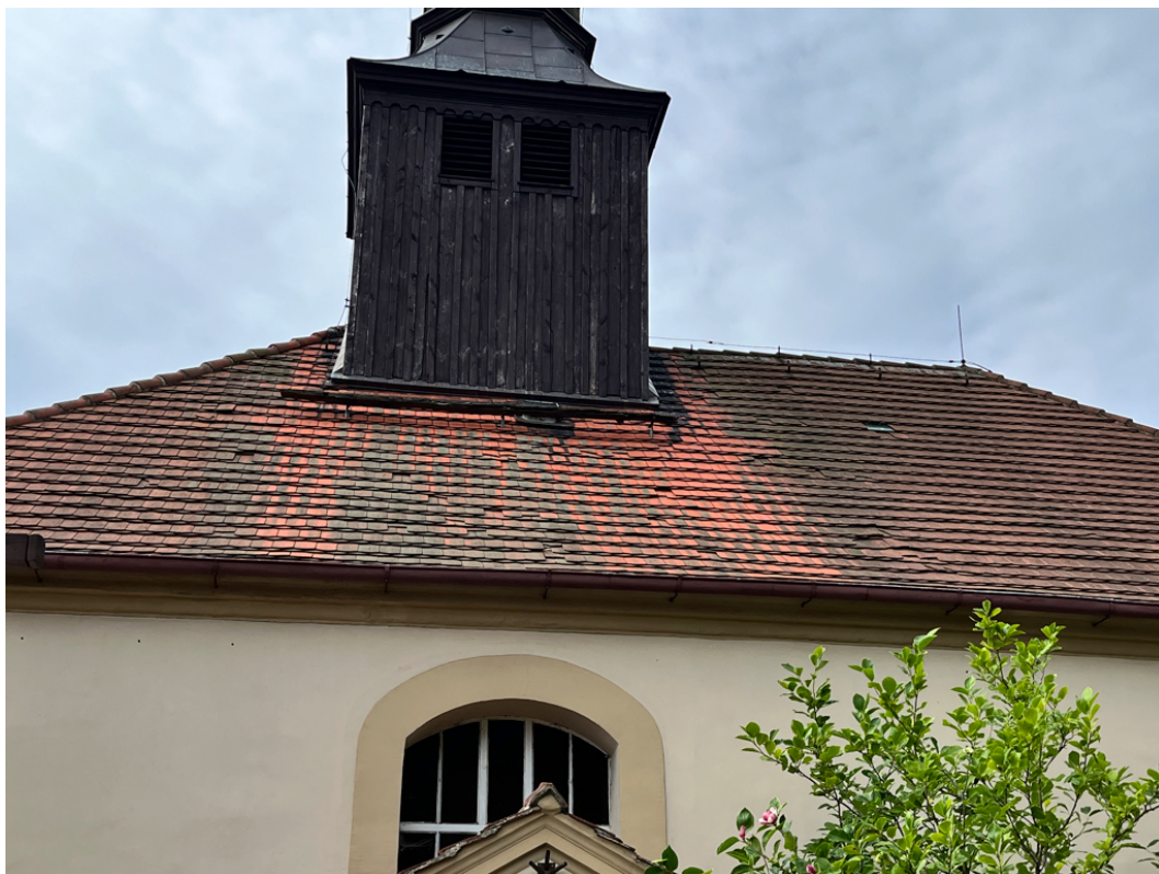
Fot. 5. Północna połać dachu, widoczne m.in. liczne mechaniczne ubytki dachówek oraz zniszczenia drewna w obrębie ławki dachowej
