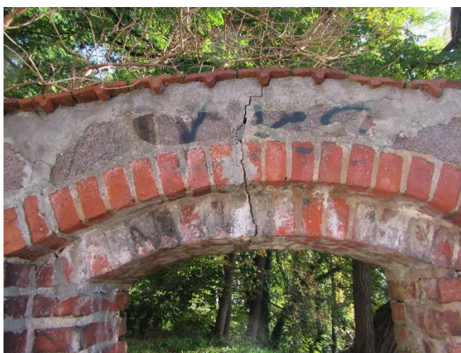
Pęknięty łuk nad wejściem
