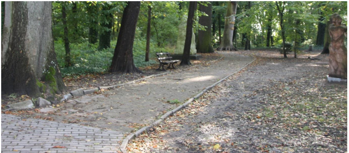
Połączenie chodnika betonowego z nawierzchnią z kostki.
